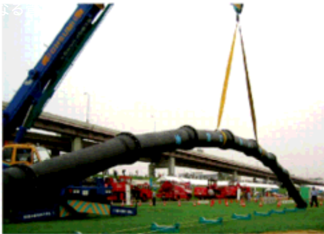
▲ 抜け出し防止継手の水道管
